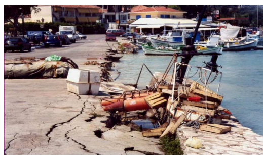
Σχήμα 12. Ρωγμές και καταβύθιση τμήματος της προκουμαίας στη Λυγιά
